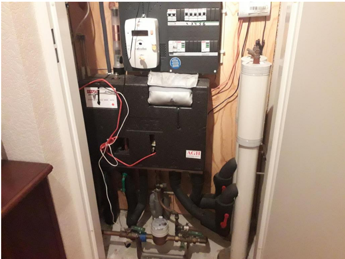
Figuur 4.1.1 Aansluiting Stadsverwarming. De zwarte doos met stickers Eneco / AGH is de geïsoleerde aansluitset.
